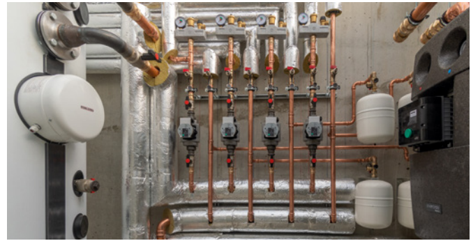
Ein Blick in die klimafreundliche Wärmepumpen-Heizzentrale.
