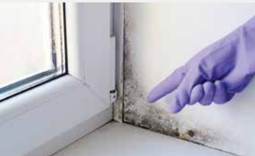
1 Hier wurde nicht richtig gelüftet oder geheizt. Die Folge ist Schimmel.
