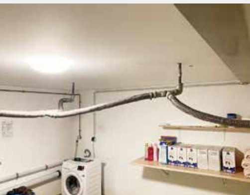
1 Wasserschäden müssen aufwändig behoben werden.
