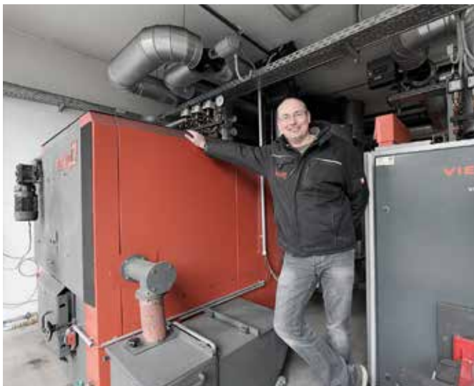
Das Heizwerk in der Sarstedter Mörikestraße wird mit Heizöl und Pellets betrieben.
