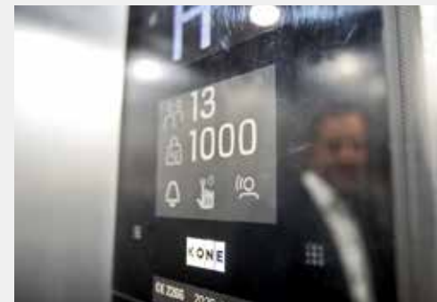
3 Ein Blick auf das Display in der Kabine.
