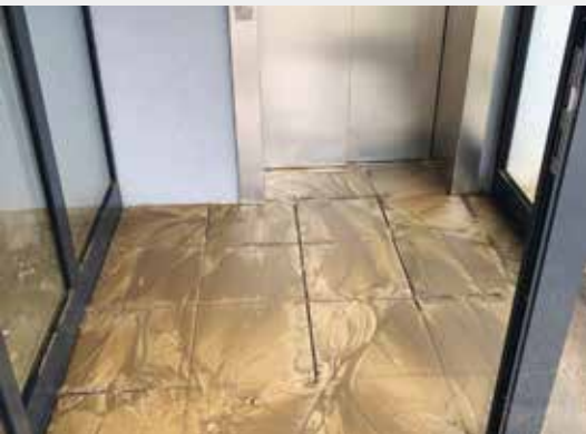
4 Hochwasser macht auch vor Fahrstühlen nicht halt.
