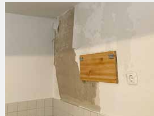
3 Hier drang Wasser durch die Wand.
